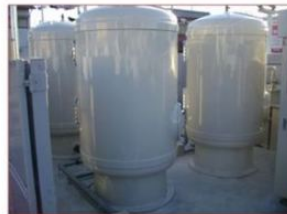
吸着ろ過設備
